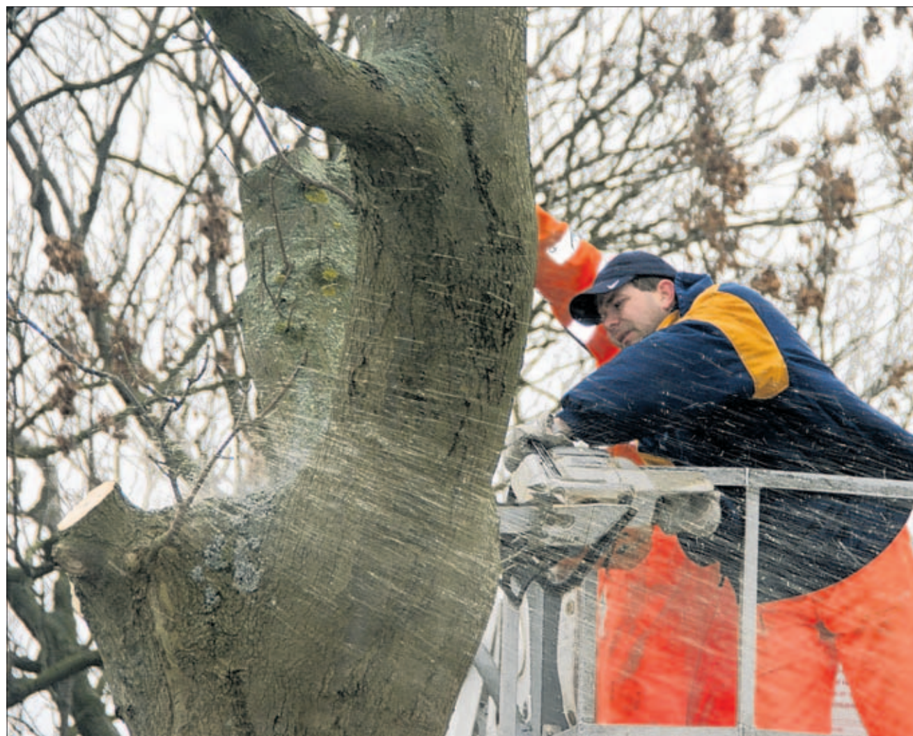
Arbeitet seit gestern auf Rügen im Akkord – Enrico Jürß und Kollegen eines Baum- und Landschaftspflegebetriebes aus der Nähe von Greifswald nehmen kranke Alleebäume ab. 17 Eschen- und Ahornbäume werden an der Straße zwischen Altenkirchen und Putgarten gestreckt, an Kreisstraßen werden insgesamt 258 Bäume gefällt.
